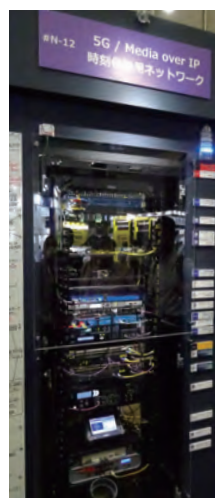
ShowNet会場に設置された5G/Media over IP時刻供給用設備
